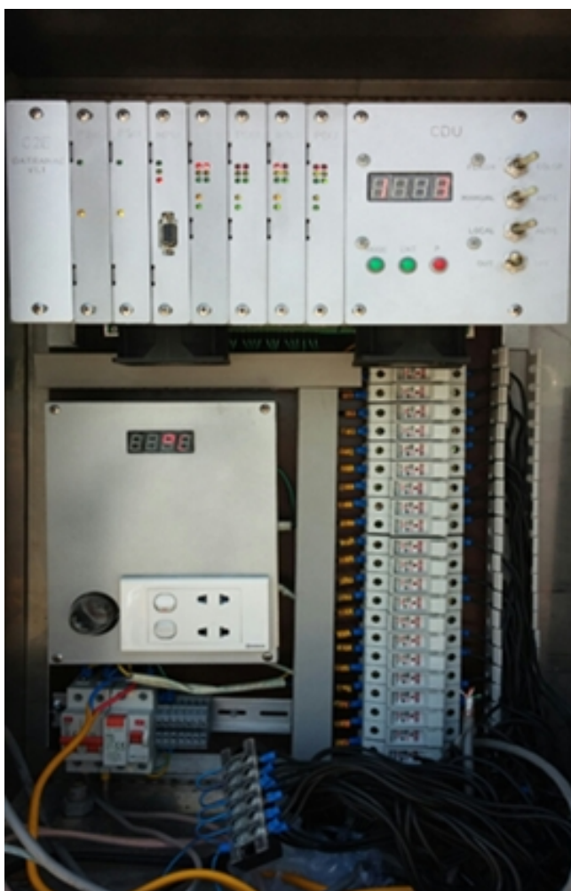
Tủ điều khiển DATRAMAC-V0
